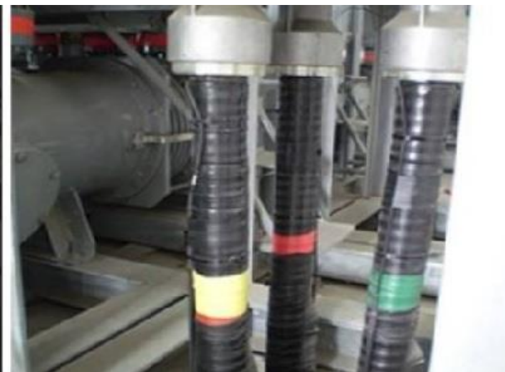
电缆接头温度监测
