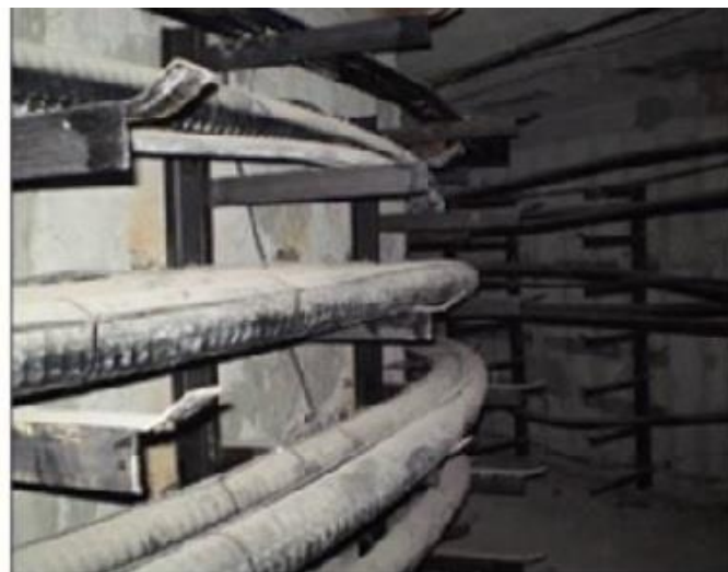
高压电力电缆温度监测
