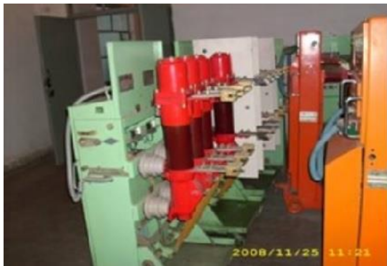
电力开关柜触头温度监测
